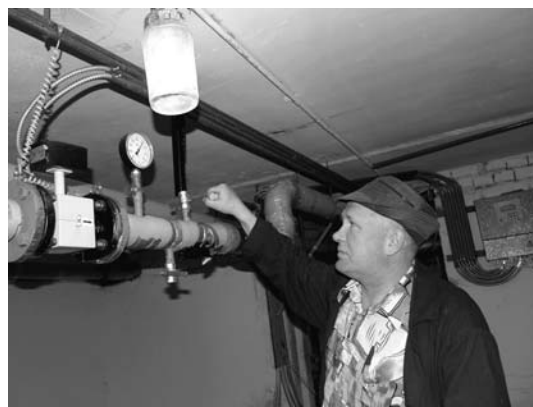
Слесарь-сантехник 6 разряда Г. Бекренев производит контроль на узле учета холодной воды
