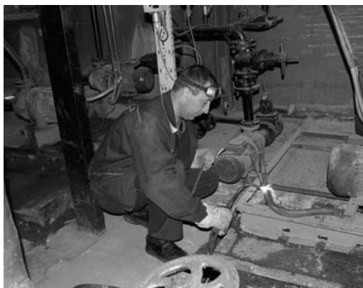
Прорвало трубу центрального отопления. На устранение повреждения направили сварщика 5 разряда А. Ручалева
